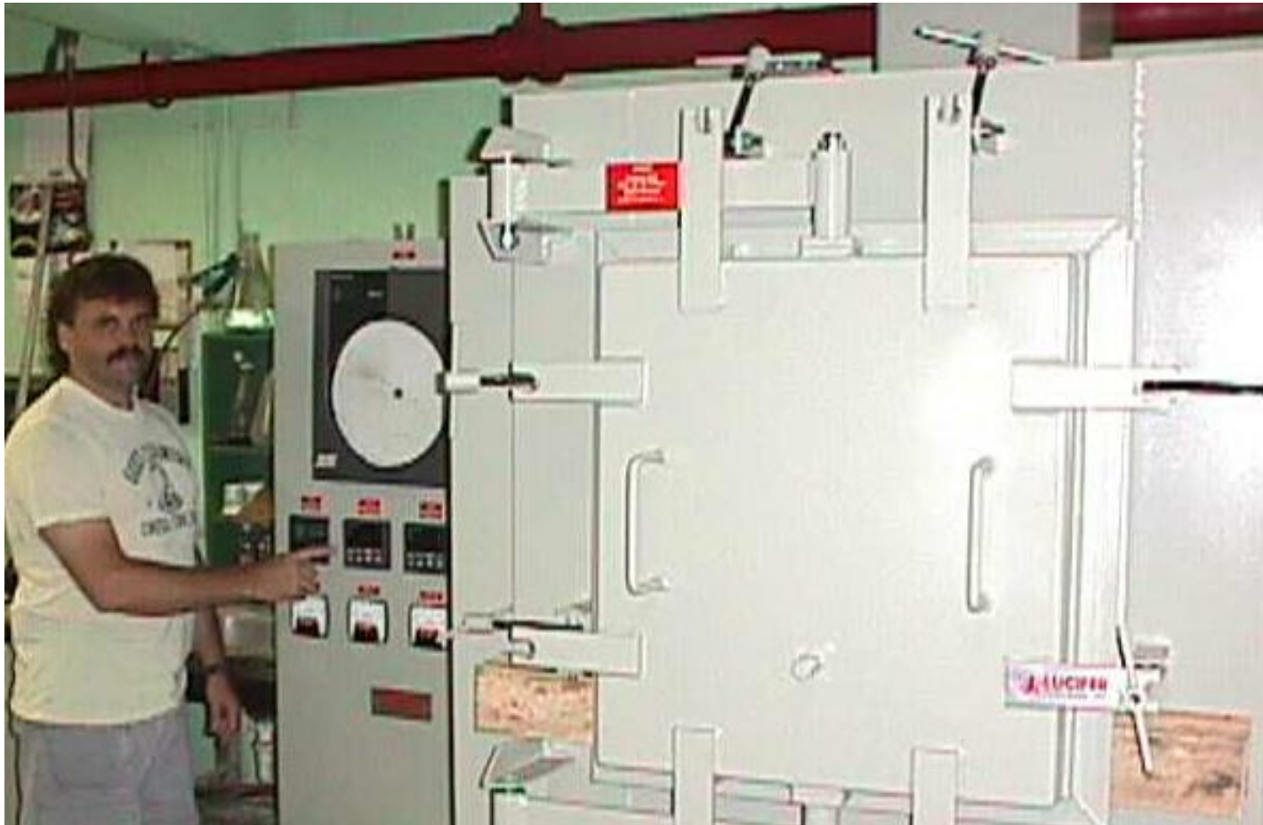
Painel de Controle de um Forno Eléctrico
