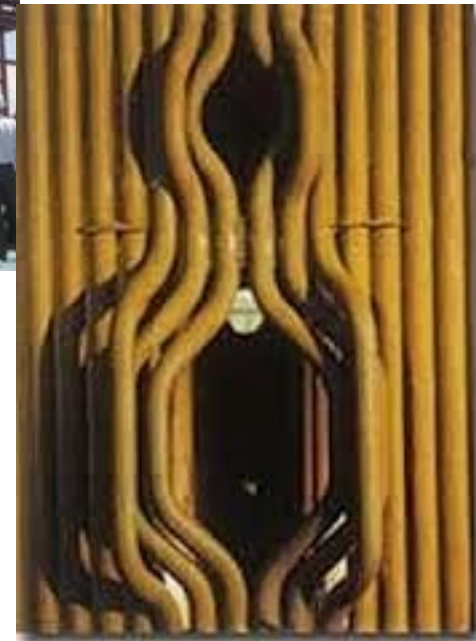
Figura 11.17 Paredes de água
