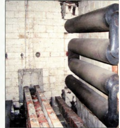
TUBOS RADIANTES INSTALADOS NA PAREDE DO FORNO
