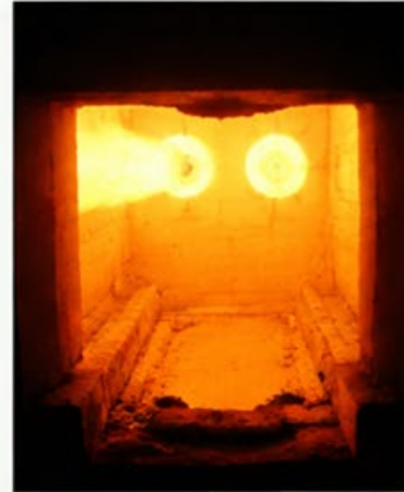
INTERIOR DO FORNO (combustão no tubo radiante)
