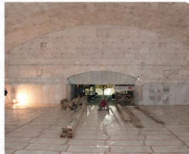
Abóbada com revestimento refratário
